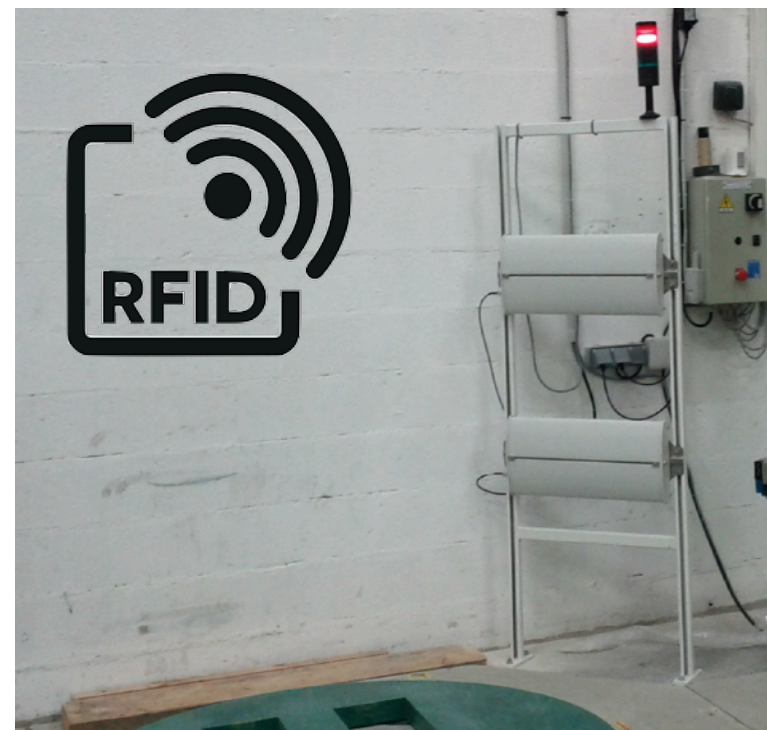
Détection sur le poste de palettisation
